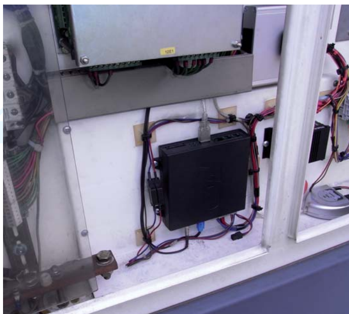
Einbau des Telematikrechners FB 4000 in der GPU
